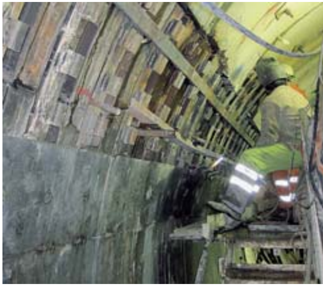
Cantiere La posa dei conci metallici al posto di quelli in cemento
